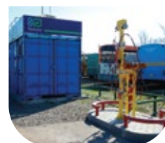
Telšiai 2015 / 150m3H / 10 / autonominė / CNG+HO / greitas pildymas
